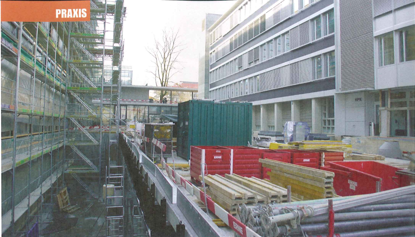
Die Bauarbeiten sind in vollem Gang: 2012 soll das Gebäude fertig gestellt sein.
