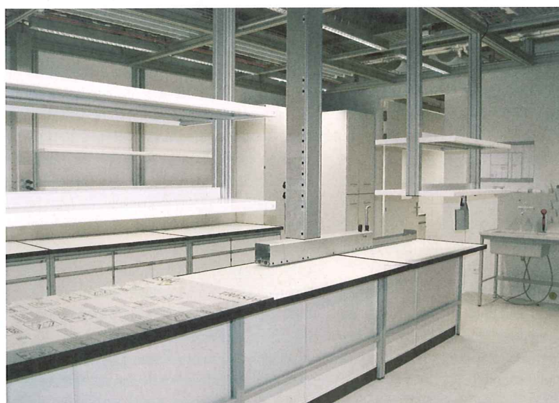
Am Muster dieses Labormoduls wurden die Installationen des Grundaubaus getestet.
